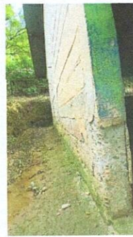
Foto 2: Columnas desmoronándose debido a humedad.
