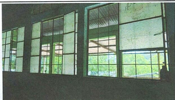
Foto 11: Ventanas en mal estado.
