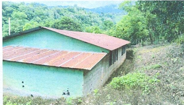
Foto 8: Techo de lamina con falta de mantenimiento.
