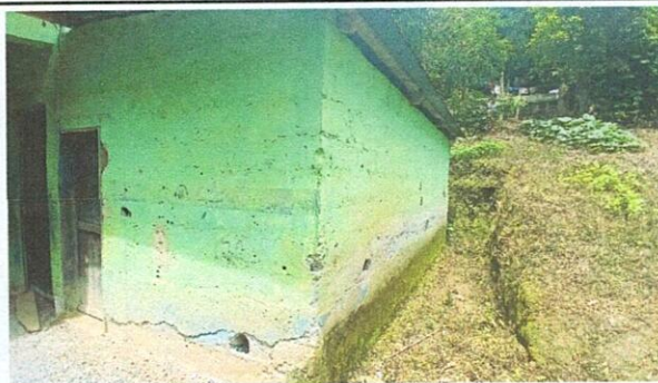
Foto 4: Paredes con agujeros debido a la mala calidad del material, así como personas que ingresan con malas intenciones.
