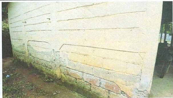
Foto 1: Cimiento en deterioro debido a la humedad, antigüedad y mala calidad de los materiales.
