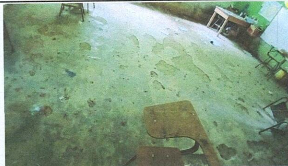
Foto 6: Piso de cemento en muy malas condiciones.
