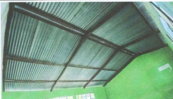
Foto 7: Cubierta de lamina acanalada de baja calidad y estructura de techo.
