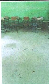
Foto 5: Piso de concreto casi inexistente ya.
